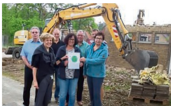
Vorstandsmitglieder und Übungsleiterinnen des TuS Bodenteich trafen sich jetzt mit Vize-Bürgermeister Werner Schulz an der Baustelle des neuen Übungsraums.
